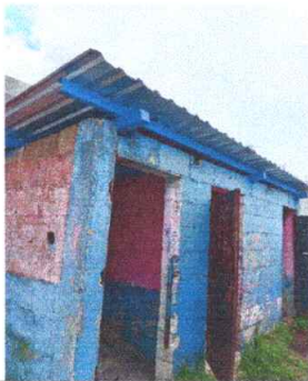
Foto 3: QUITADO DE PUERTAS DE SANITARIOS EN MAL ESTADO.
